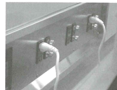
写真20 コンセントモジュール
